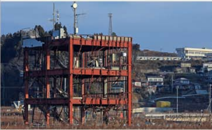
【南三陸町防災対策庁舎】鉄骨3階、高さ12メートル。東日本大震災で15.5メートルの津波に襲われ、骨組みだけが残った。佐藤仁町長は2013年9月、町単独では保存経費が重荷になることなどを理由に解体を表明。同年12月、県が震災遺構有識者会議の検討対象に防災庁舎を加え、解体は実質的に保留されている。現在は施設、土地ともに南三陸町が所有している。
