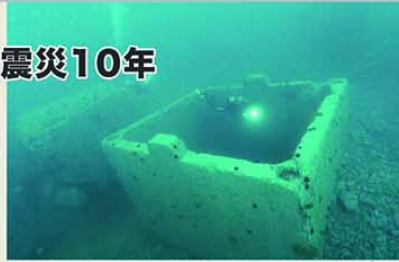
▲海中に崩れ落ちた越喜来(おきらい)漁港の防波堤の残骸 2020年10月6日、岩手県大船渡市(撮影・諫山卓弥)
